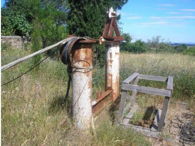
Photo 1 : Tuyaux au Panneau Sud
