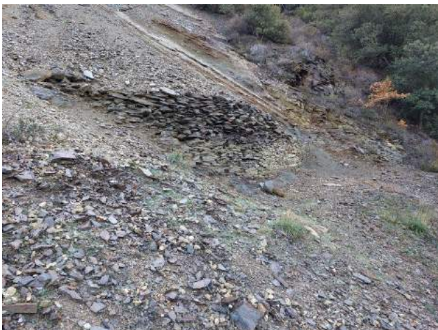
Photo 6 : Pas de glissement de la versé fin 2021 (14/12/21)
