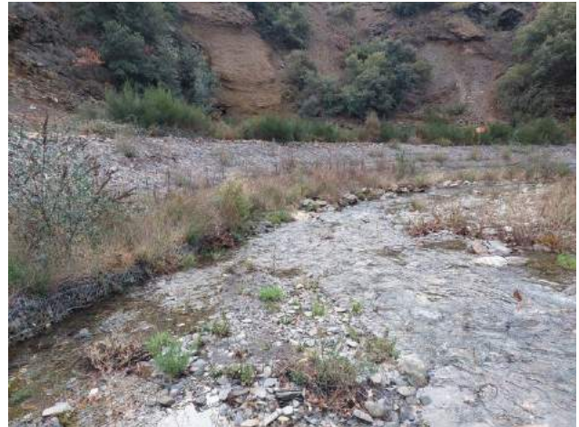
Photo 5 : Enrochements en pied de versé après les 2 épisodes pluvieux (29/12/21)
