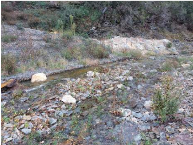
Photo 4 : Protection en enrochement en sortie de virage après épisode de novembre (29/11/21)
